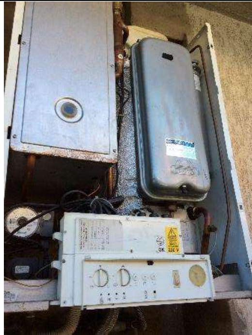
Foto 26: Caldaia abitazione n. 2 (sub 7)
