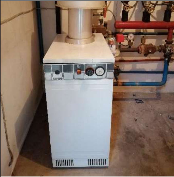
Foto 25: Centrale termica relativa all'abitazione n. 1 (sub 3)
